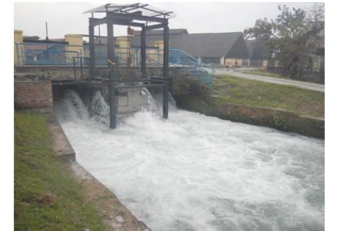
インドに設けられた流水式小水力発電装置。
