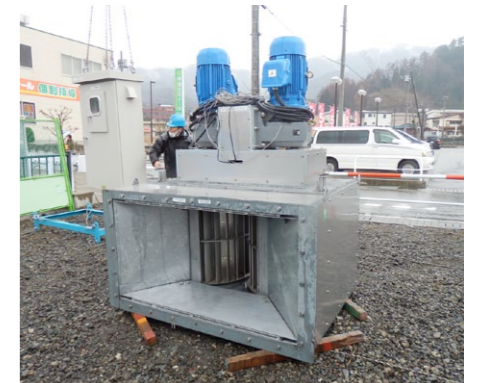
流水式小水力発電装置の水車・増速機・発電機。出力タイプ別の標準化によって、共用部品・汎用部品による仕様とし、安価なユニット化を実現している。
