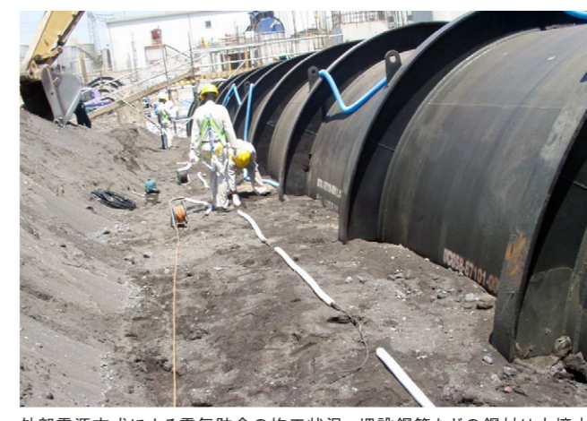
外部電源方式による電気防食の施工状況。埋設鋼管などの鋼材は土壌中で腐食するため、電気防食により腐食を防いでいる。白い棒状のものは防食材料「MMO陽極」。
