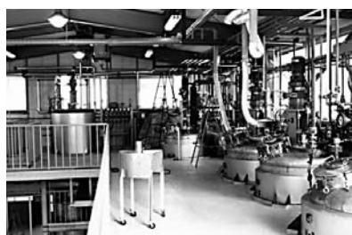
防爆対策を施した生産設備
