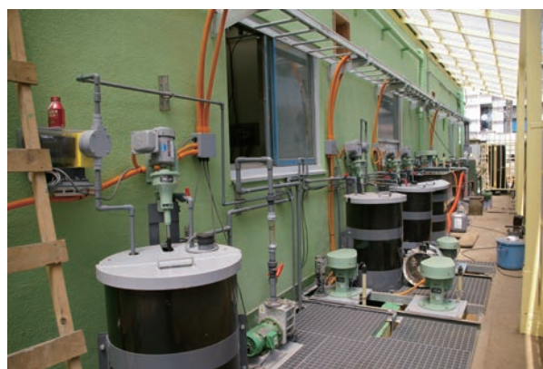
都南ビーピー 工場排水設備 IMG1012
