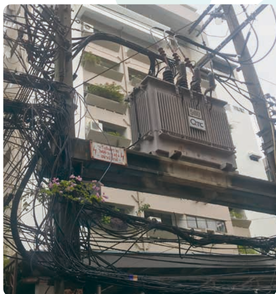
タイの配線状況
