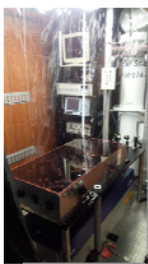
コンテナ内部
