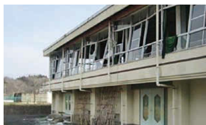
窓枠が落下した建物 (文部科学省「学校施設における非構造部材の耐震対策の推進に関する調査研究報告書」 (平成26年3月)より)
