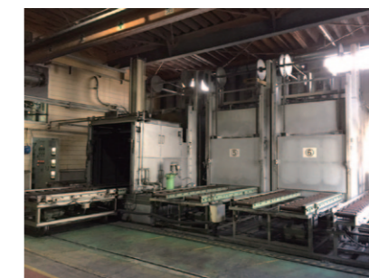
熱処理フロア(ガス炉)
