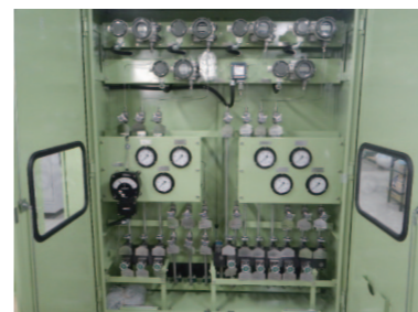
制御油装置計器収納盤(石炭火力発電制御) オイル用配管
