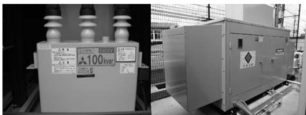
進相コンデンサ(左)非常用自家発電設備(右)
